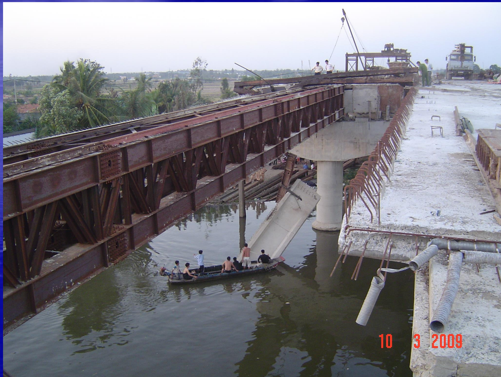
SỰ CỐ GÃY DẦM CẦU CHỢ ĐỆM (2009)
