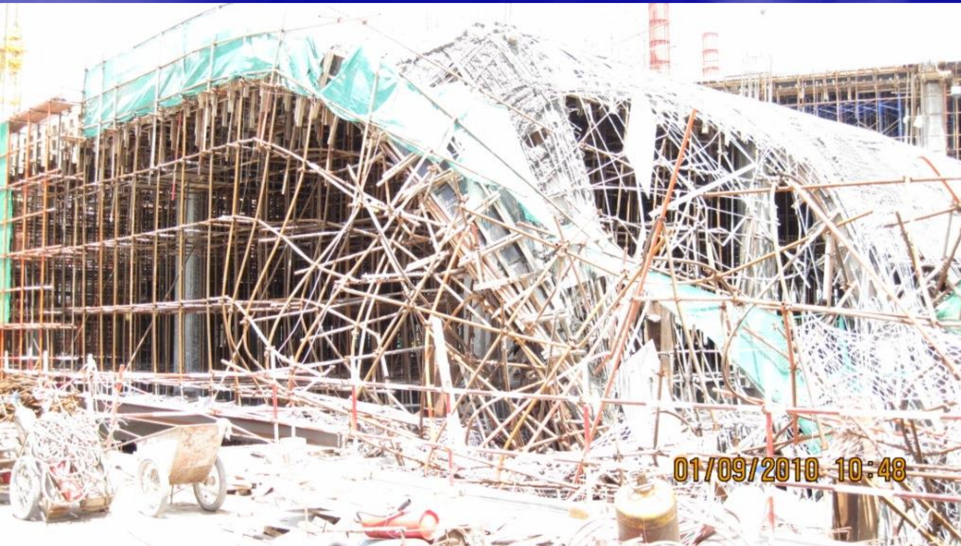
SẬP SÀN BT VỪA ĐỔ DO CHỐNG KHÔNG HỢP LÝ TẠI PMH (2010)
