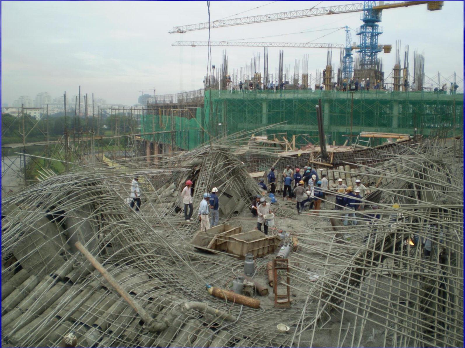
SỰ CỐ CAO ỐC VP PHÚ MỸ HƯNG (SẬP 800M 2 ) - 2008
