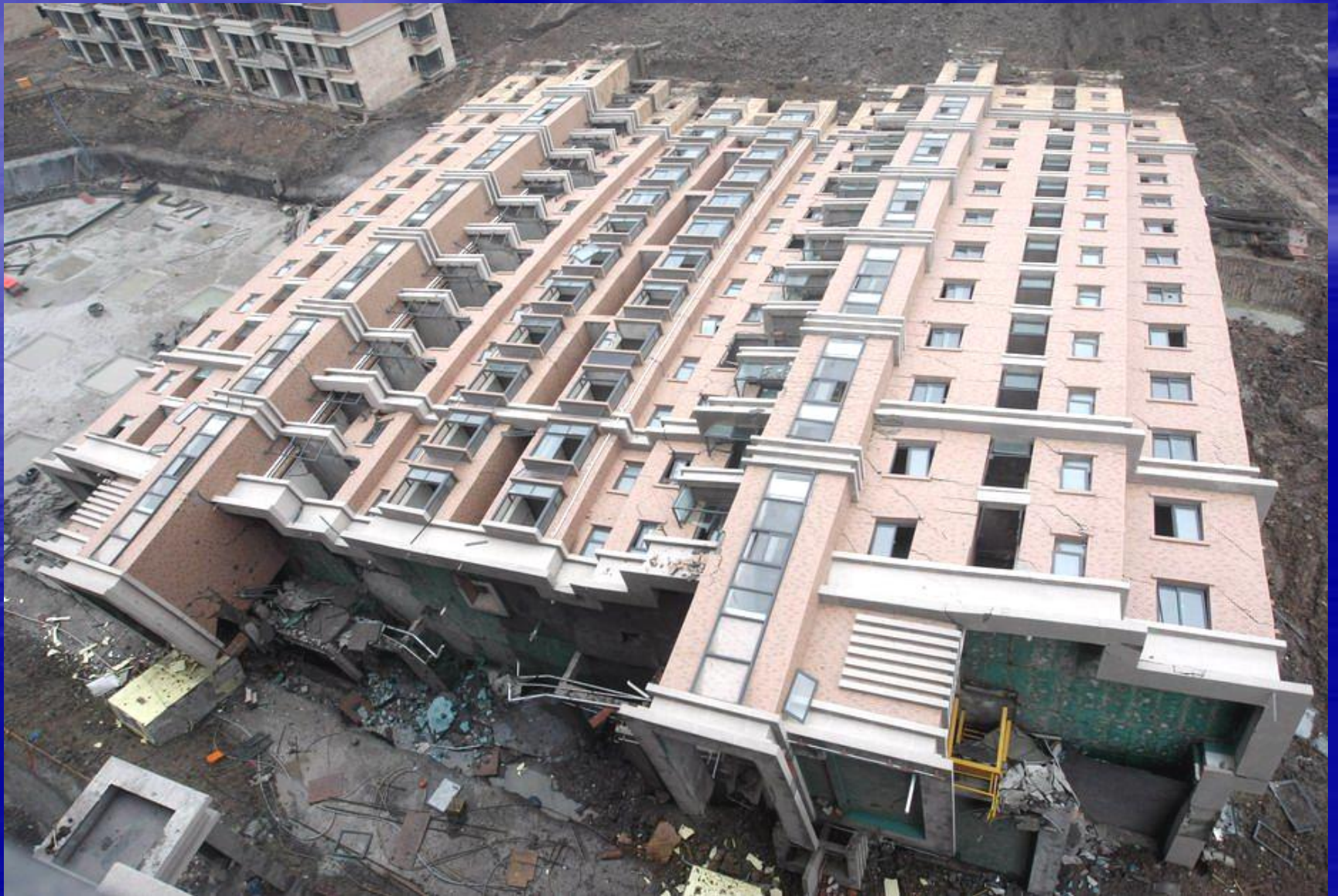
TRUNG QUỐC: BLOCK CHUNG CƯ BỊ ĐỔ NGANG, THEO PHƯỜNG NGẮN (CHỤP TỪ ĐỈNH) - 2009
